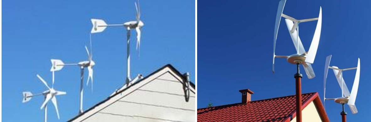
Rysunek 7. Przykłady małych turbin wiatrowych. Po prawej z poziomą osią obrotu, po lewej z pionową osią obrotu Źródło: Poradnik Małej Energetyki Wiatrowej, K. Nalepa
